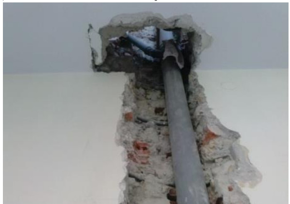
RURY KANALIZACYJNE OKAZUJĄ SIĘ RÓWNIEŻ DO WYMIANY
